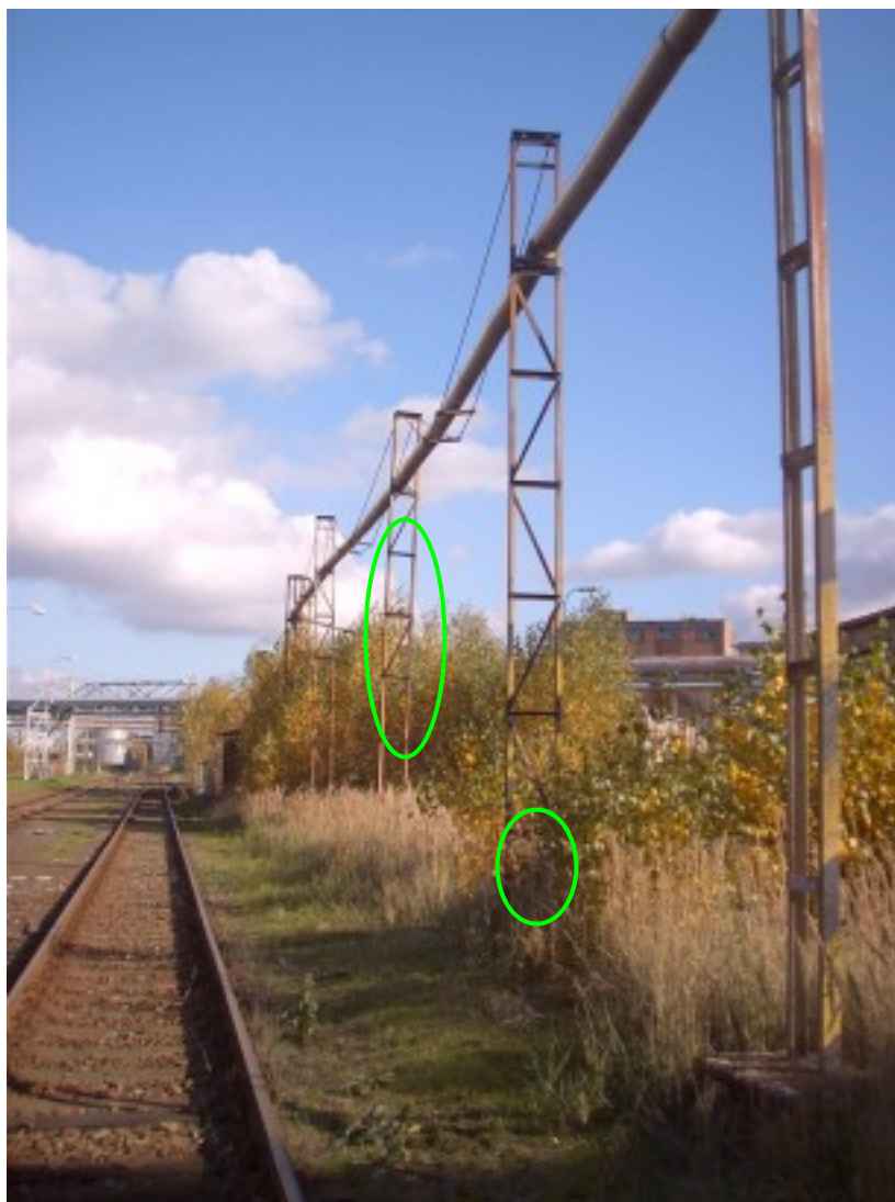
Foto 2 : Pohled na most A1 U 18 P, na mnohých sloupech odkorodované L diagonály
