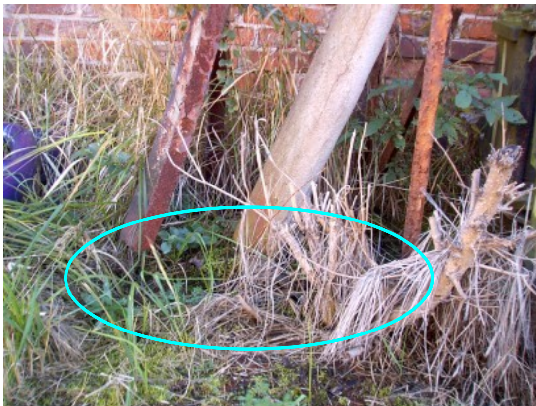
Foto 6 : V husté trávě pohled na odkorodované spodní díly sloupu mostu A1 S 18 P
