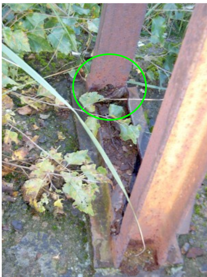
Foto 4 : Prokorodované U stojiny sloupu č.3, obdobné i u sloupů 2 a 5
