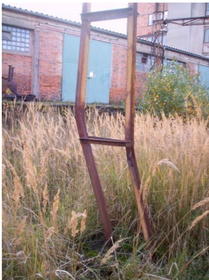
Foto 3 : zdeformovaný sloup č. 4, chybí také odkorodované L diagonály
