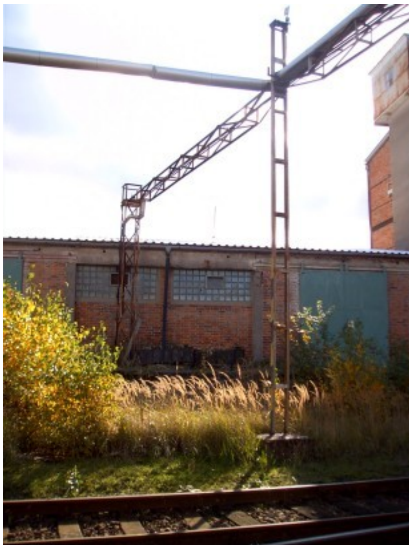
Foto 5 : Pohled na most A1 S 18 P (vlevo) a část mostu A1 S 19 P
