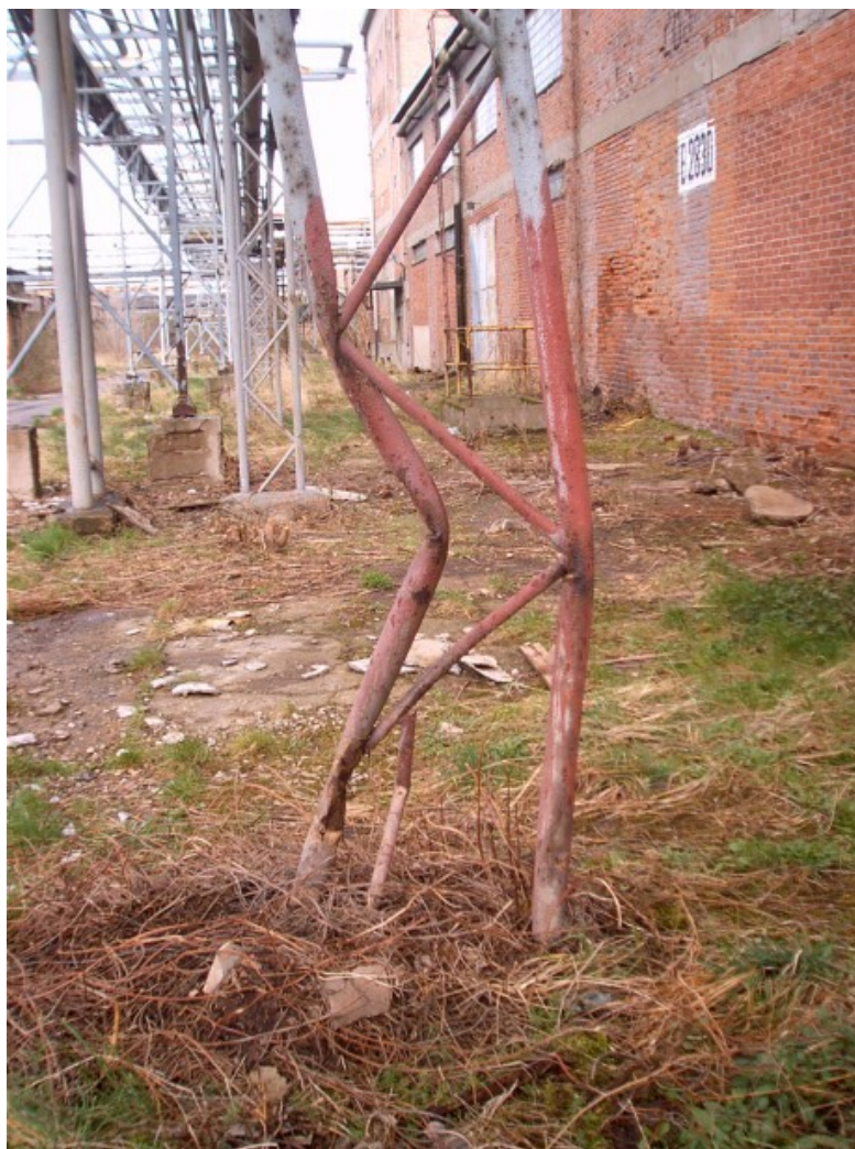
Foto 3 : zdeformovaný sloup č. 8b – nutná výměna
