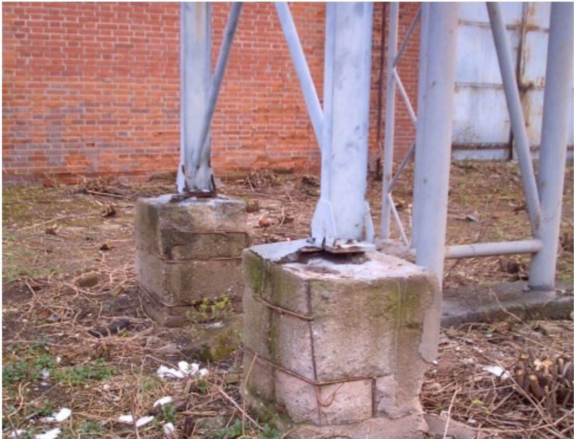
Foto 5 : poškozené, nedolité základy sloupů 9 (obdobné i u sloupů 10 až 13)
