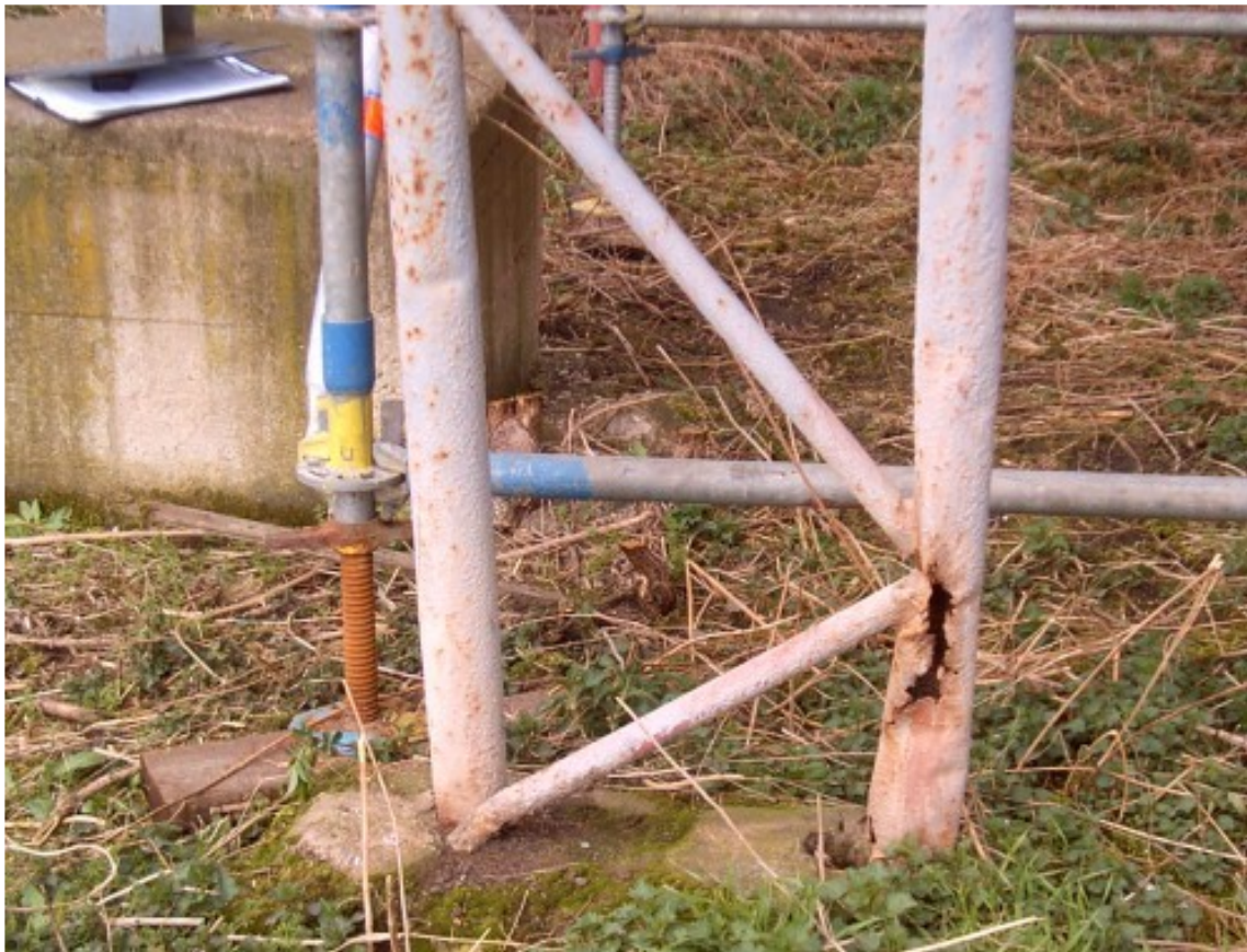
Foto 2 : korozí silně poškozené stojiny sloupu 7b pomocného mostu
