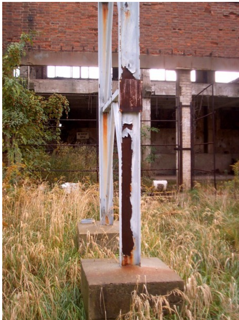
Foto 6 : poškození ochranného nátěru na jednom z hlavních sloupů
