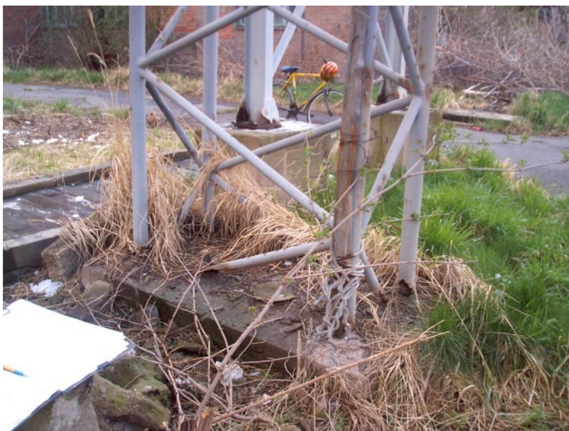
Foto 4 : zkorodované trubky sloupu č. 13c
