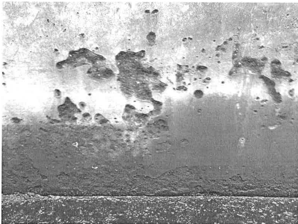
foto č.1 – D1760: poškozená stěna jímky u kanálku
